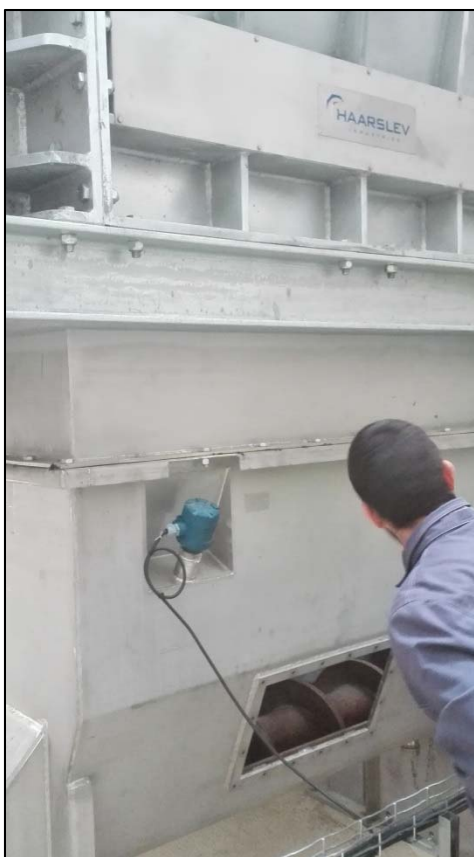
Figura 6. Tolván de pasta triturada, provisto de un medidor de nivel.
