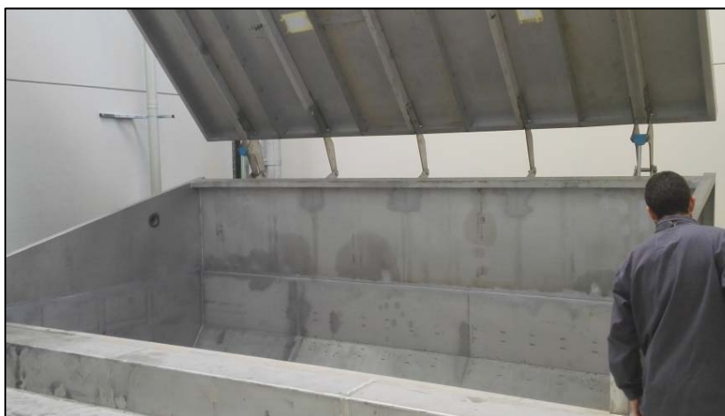
Figura 3. Tolva de recepción
