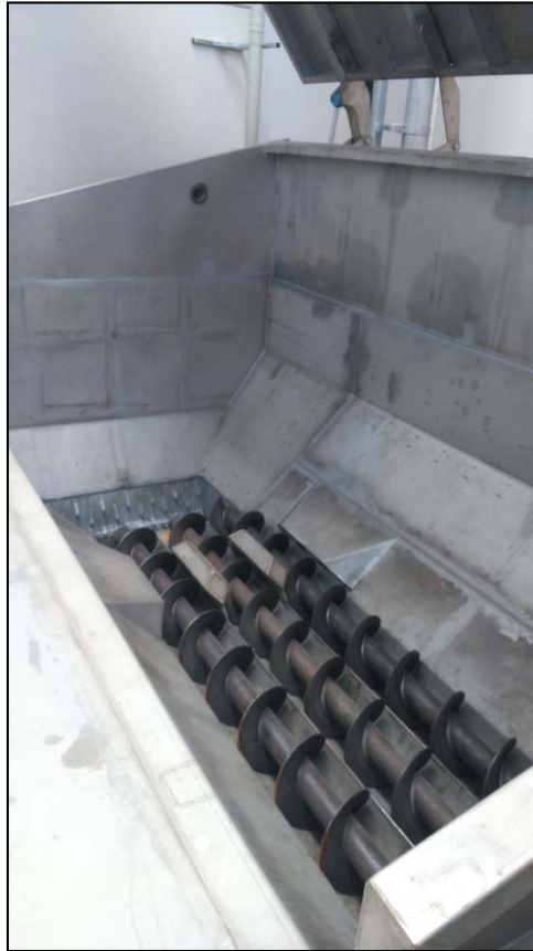
Figura 4. Sinfines de alimentación al triturador
